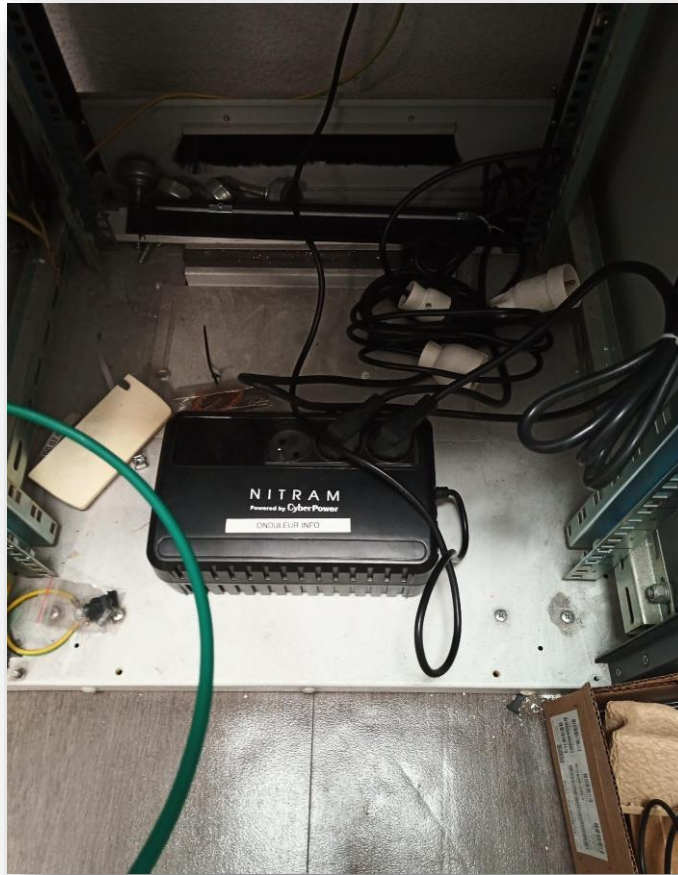
Figure 14 : Déploiement d'un onduleur
